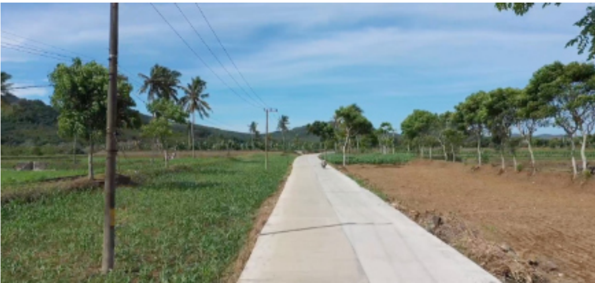
Pembangunan jalan Pancer – Pulau Merah sepanjang 3,85 km dan lebar 6 m di Desa Sumberagung, Kecamatan Pesanggaran, Banyuwangi, telah mencapai target. Pembangunan jalan ini merupakan tahap kedua dari tiga tahap pembangunan jalan dari pertigaan Lowi, Dusun Silirbaru hingga Dusun Pancer. Proyek ini merupakan kerja sama antara PT BSI dengan Pemda Banyuwangi. (FOTO: BSI)
