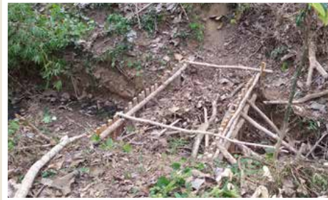
Saringan sedimen penirisan semak pada aliran kecil Bush drain sediment filters in minor streams
